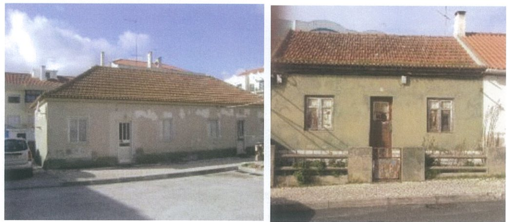
Figura 24| Estado de conservação: mau e péssimo.
