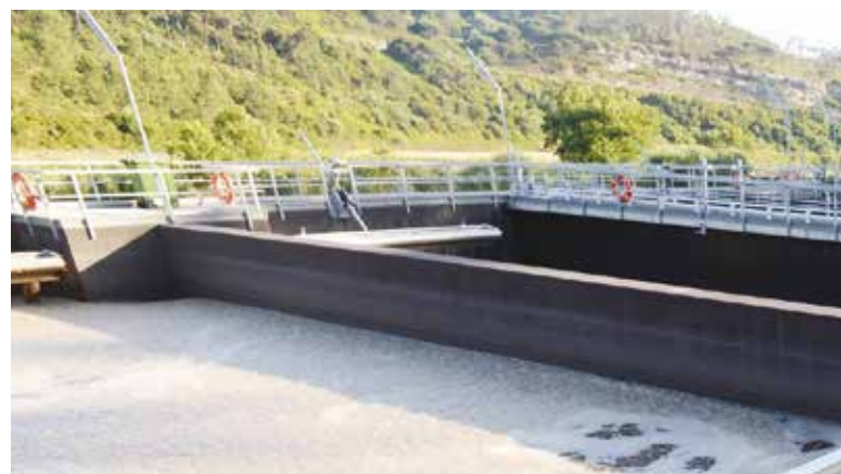
A ETAR dispõe de soluções técnicas que minimizam riscos de descargas poluentes e de emissões de odores
