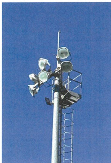
Fig.6 – Sistema de iluminação exterior do Estádio Municipal Venda do Pinheiro.
